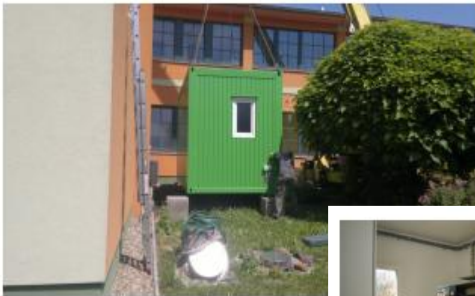
Obrázek 2. Ocelový kontejner s antradoxovým zařízením v SÚRO
